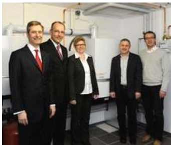
(v.l.n.r.) Dr. Carsten Stelzer (Vaillant), Ralf Klöpfer (EnBW), Beate und Klaus Schmitt, Bürgermeister Sven Weigt bei der offiziellen Inbetriebnahme der Brennstoffzellen-Heizung in Karlsdorf
